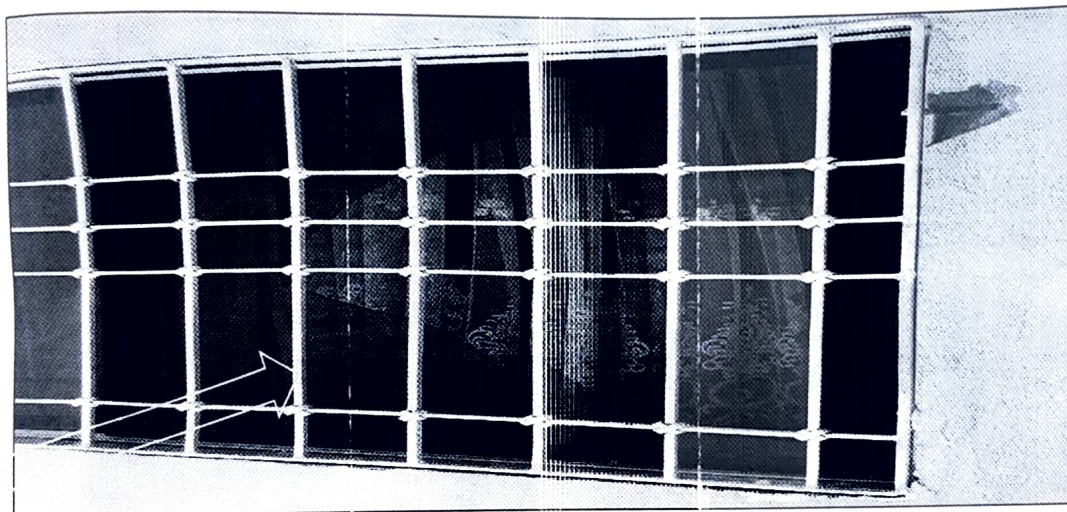
PANORAMICA FOTOGRAFIA No 1 EN LA IMAGEN SE ILUSTRA EL VIDRIO ROTO DE LA VENTANA DEL FRENTE DEL INMUEBLE UBICADO EN CALLE 41ª # 12ª-22 BARRIO DOCE DE OCTUB
